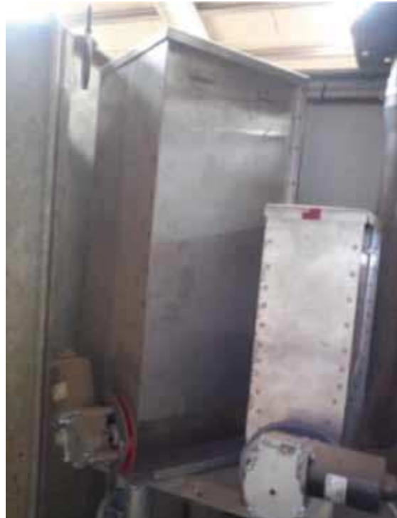
Imagen 2: Detalle del dosificador en estación de alimentación para administrar aditivos.
